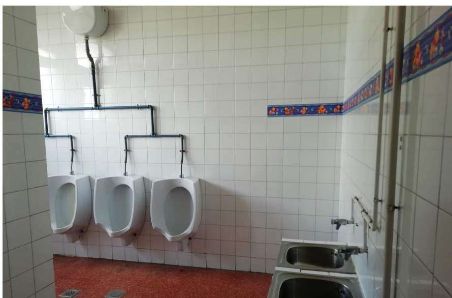
Figura 9. Aseos en edificio de primaria. Fuente: Archivo propio
